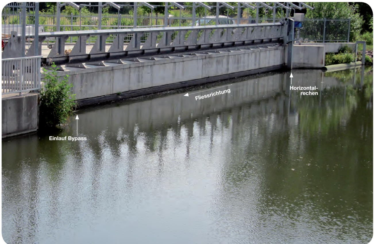
Abb. 3: Die Fischabstiegsanlage im Überblick.
